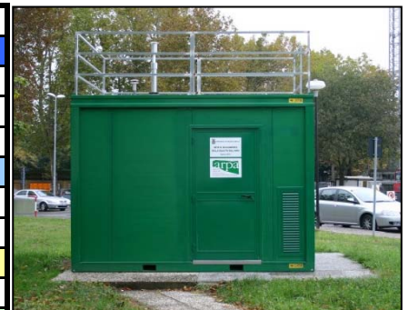
Stazione di monitoraggio della qualità dell'aria
