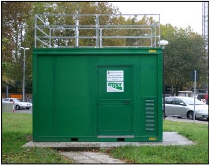
Stazione di monitoraggio della qualità dell'aria
