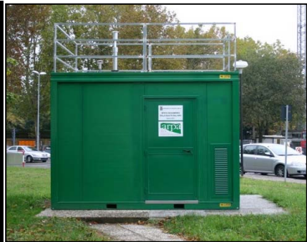
Stazione di monitoraggio della qualità dell'aria
