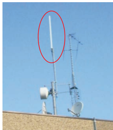
Installazione con sistema DVB-H
