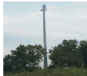
Impianto SRB H3G 5806A Via Mottaziana
