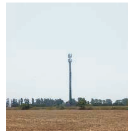
Impianti SRB TIM PC39 e WIND PC23 Strada Vicinale della Fornace di Bruso
