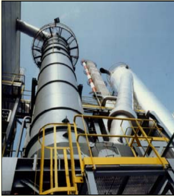
Torre di condizionamento
